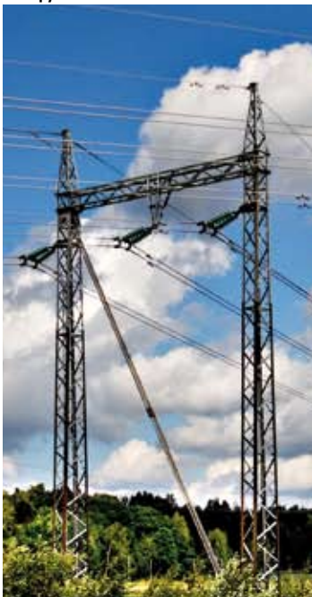
Harustettu kaksijalkainen teräspylvä
